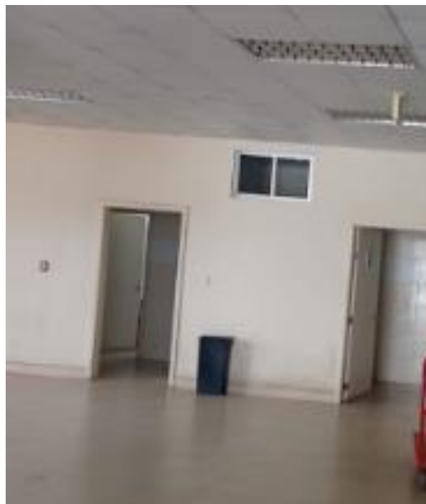
Foto No 59. Baños mujeres – Baños hombres
