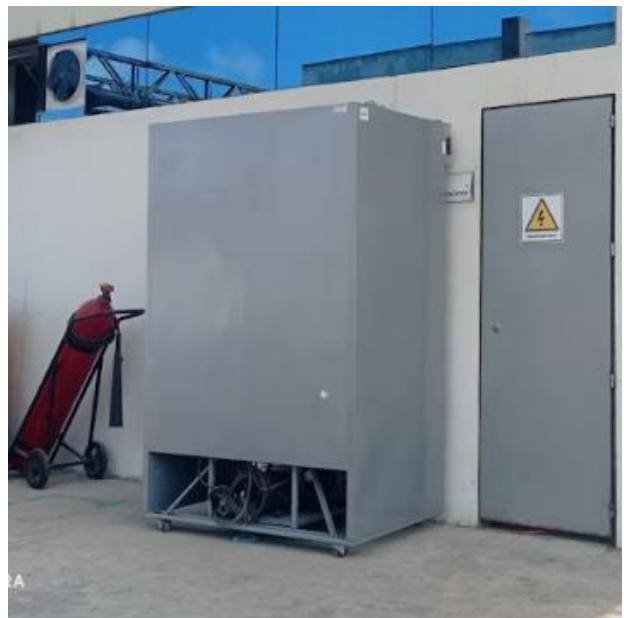
Foto No. 175. Prevención – prohibición en maquinaria
