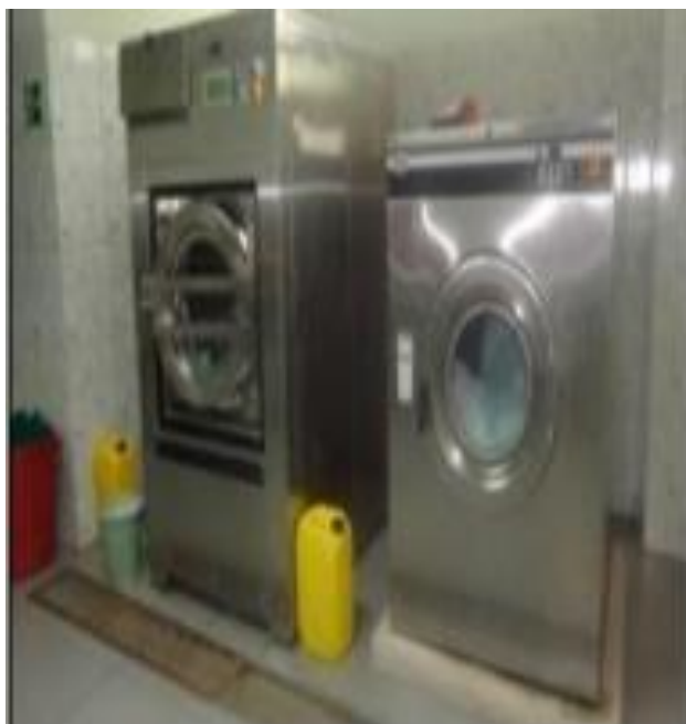
Foto No. 116. Maquinas lavadoras
