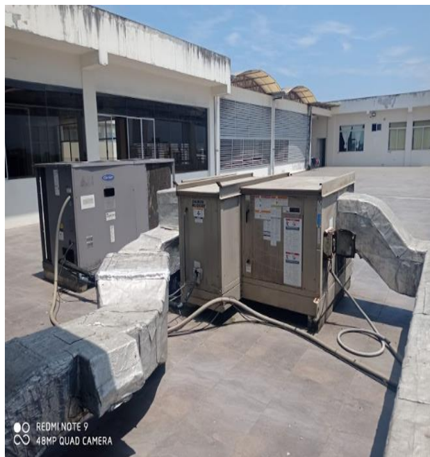
Foto No. 57. Central de aire
