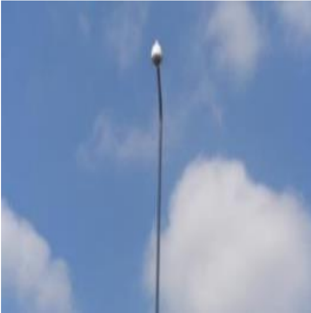
Foto No. 212. Cámara giratoria
