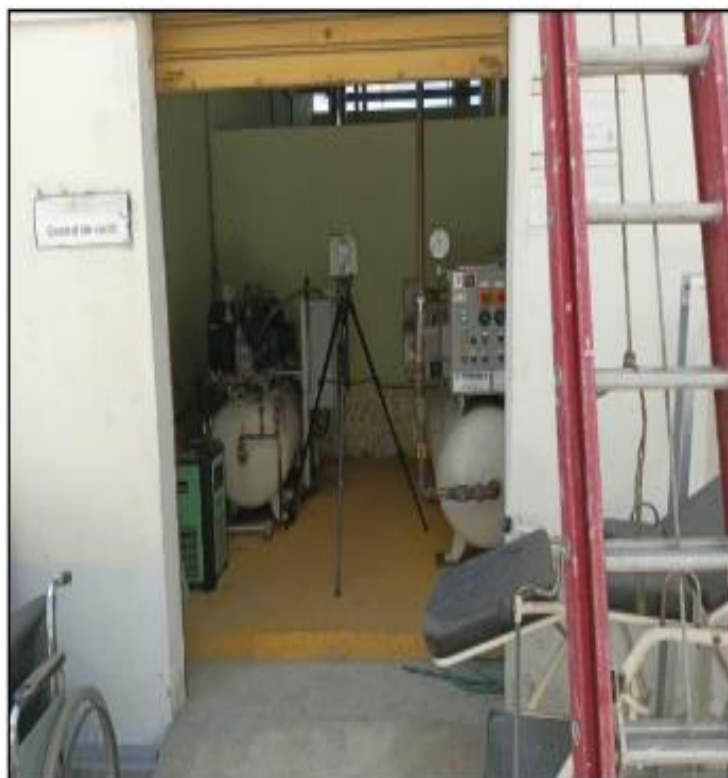
Imagen 33: Mediciones tomadas en el área de Central de vacío
