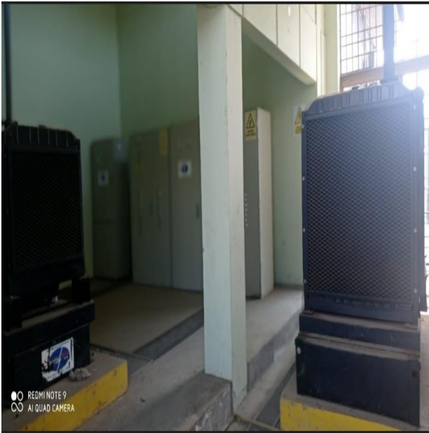
Foto No. 154. Generadores de Luz
