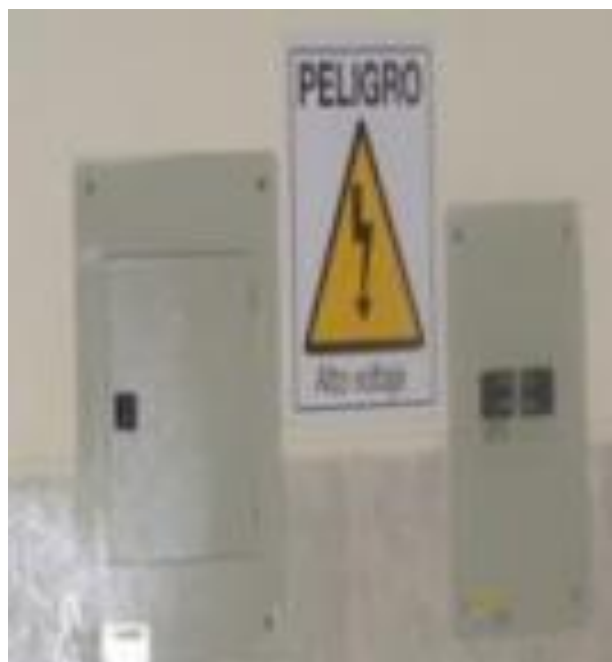
Foto No. 23. Cuadros de distribución
