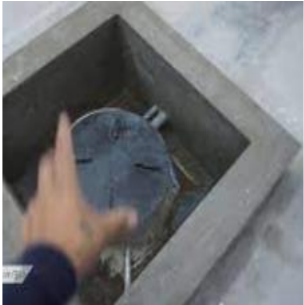
Foto No. 155. Bomba sumergible de agua
