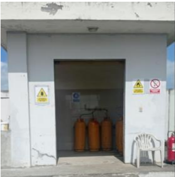
Foto No. 174. Prevención – prohibición en bodega de almacenamiento GLP
