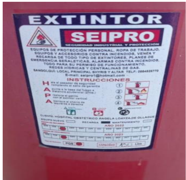
Foto No. 186. Extintor ubicado en área de máquinas de lavandería
