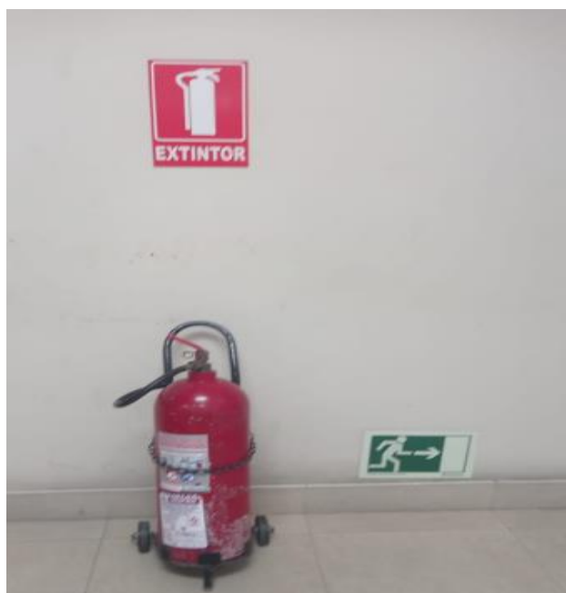
Foto No 85. Extintor y señalética
